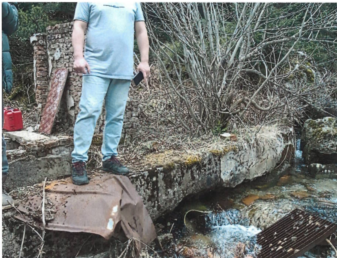
Снимка 2. Разбита решетка при водохващане на река Мальовица
